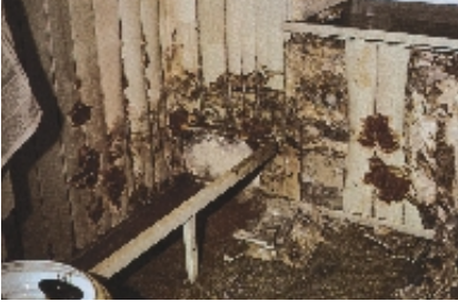
Echter Hausschwamm in Mauerwerk
