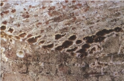
Echter Hausschwamm in Holzverkleidung
