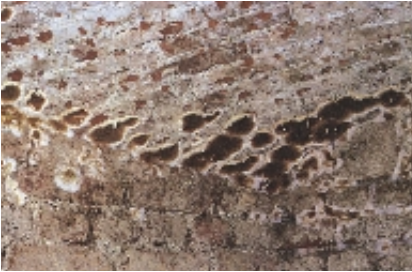
Echter Hausschwamm in Holzverkleidung
